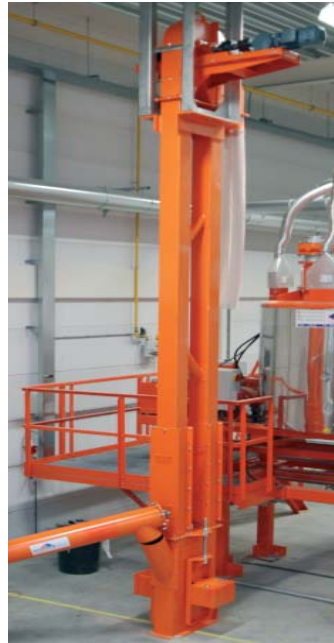
Von Schneckenförderer mit Wiegung beladenes Becherwerk.
